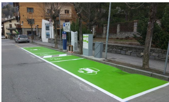
Figura 5 _ Foto di Installazione - Comune di Courmayeur (VA)
