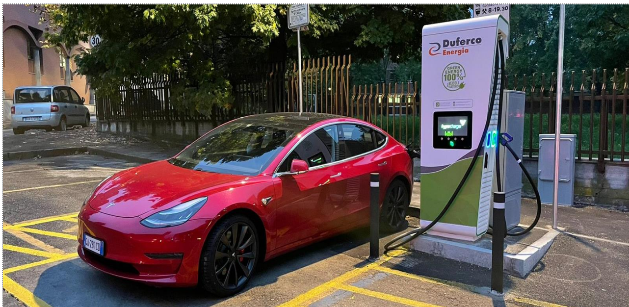
Figura 2 _ Foto di Installazione tipo infrastruttura Ultra Fast Charge – Torino Via Della Brocca
